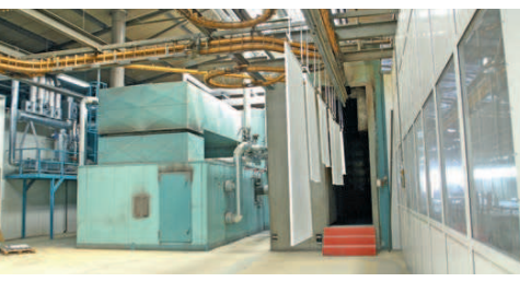
Für die Dampf-Beheizung musste in 6-8 m Höhe ein ca. 3,5 km langes Leitungsnetz installiert werden, links die Dampfleitungen, in der Mitte der umgerüstete und (für Notfälle dienende) Ölbrenner, rechts ein Einbrennofen. Quelle: Redaktion
