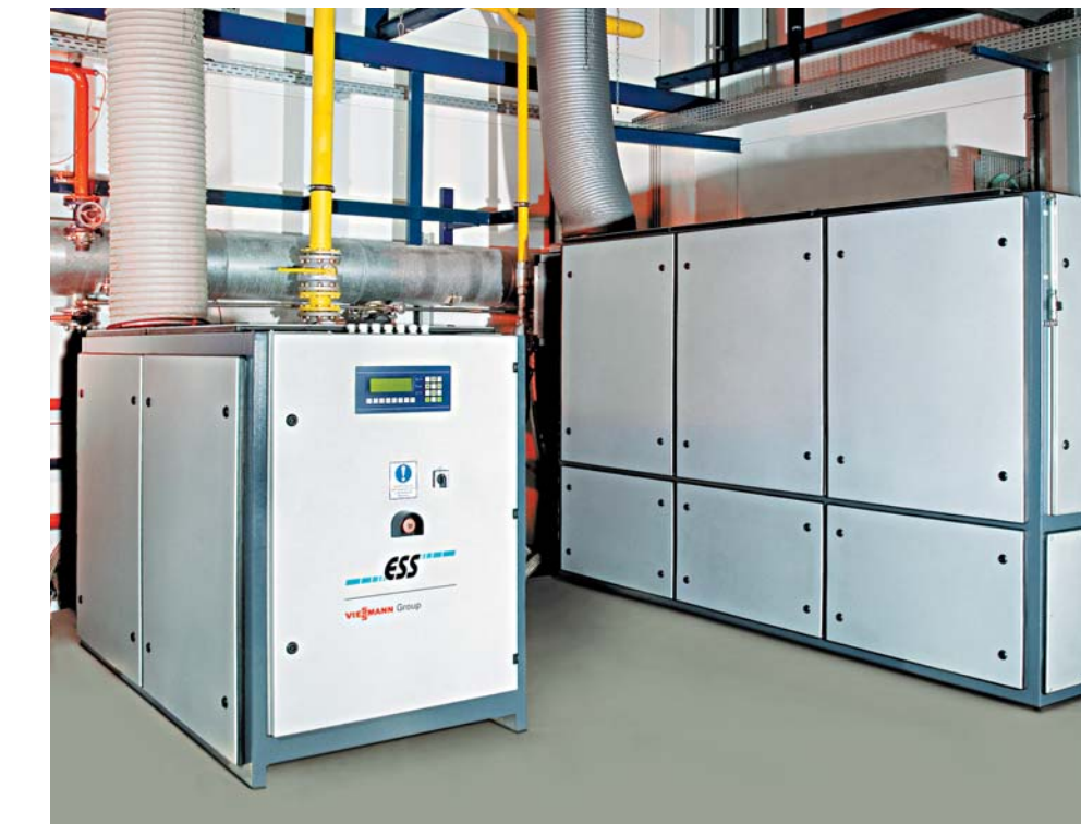
Blockheizkraftwerke. Kraft-Wärme-Kopplung nimmt einen immer größeren Stellenwert ein.
